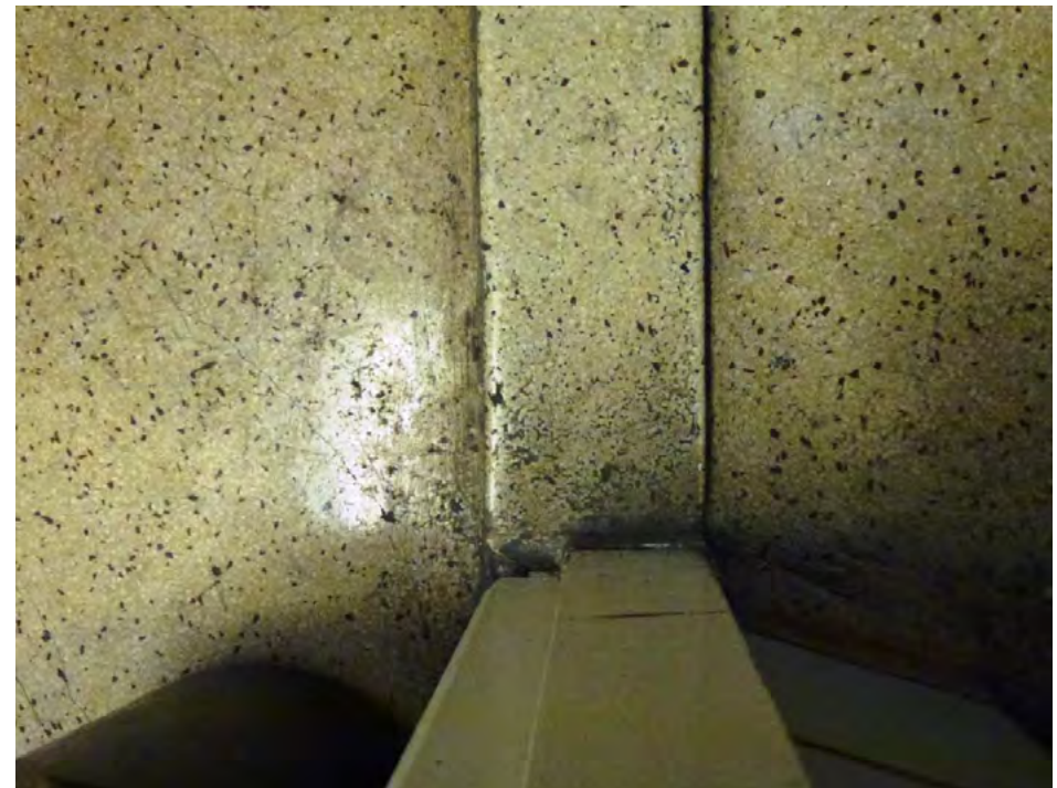
Afb: vloer en drempel toilet begane grond
