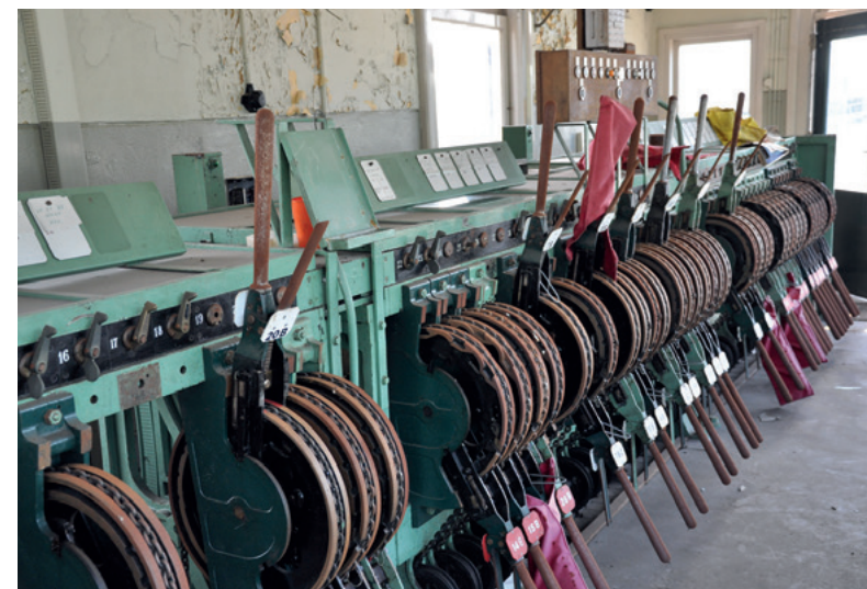
Interieur van de seinzaal van het seinhuis, met de handels voor de bediening van de seinen en wissels (niet meer in gebruik) (2010, Pro Rail)
