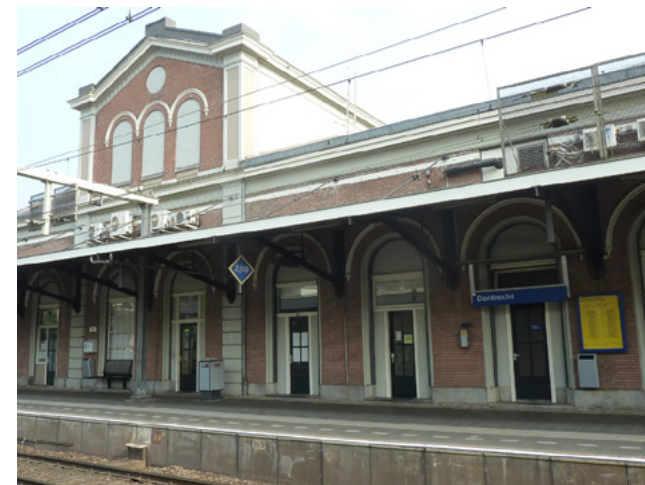
De originele deuren in de achtergevel zijn verdwenen.
