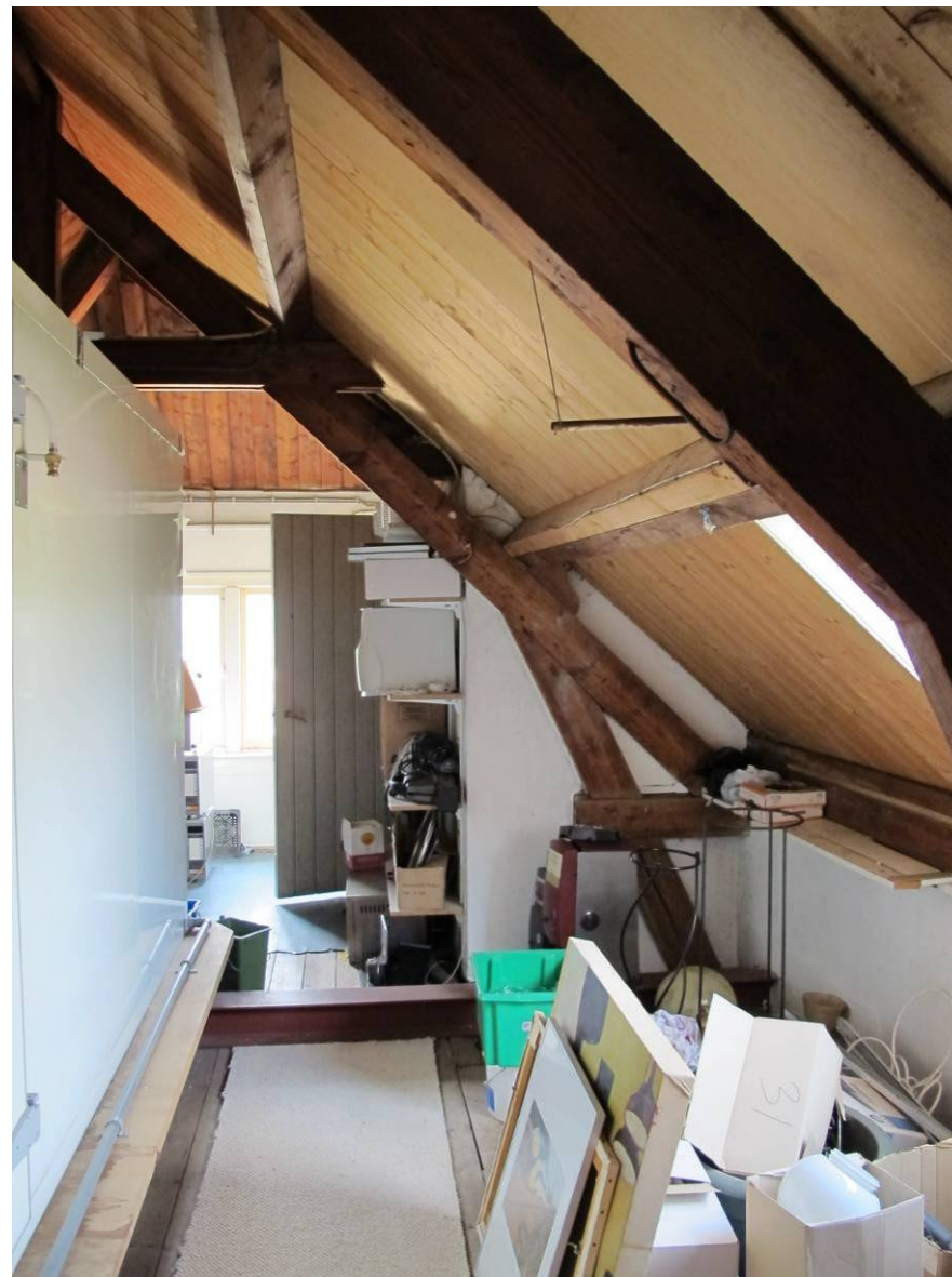
Zicht langs het noordelijke dakvlak in westelijke richting. Links is de op stalen liggers geplaatste koeling zichtbaar.
