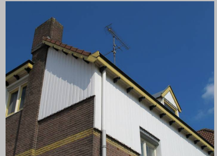
Versterking architectonische kwaliteiten door reconstructie kleurstelling en verdwenen of aangetaste onderdelen.
