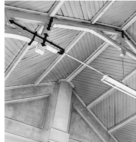
Afb. 4.8: Dakconstructie wachtkamer station Venray. Vermoedelijk bevindt zich een vergelijkbare constructie in de 3 de klas wachtkamer van station Boxmeer
